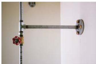
ガス管を使ったパイプハンガー
